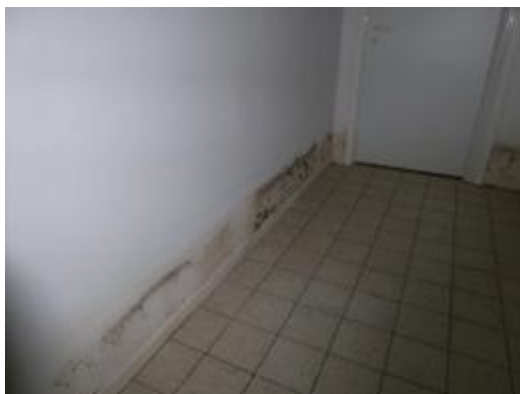
2 - Développements de moisissures, dont le genre Stachybotrys , dans un bâtiment inondé en juillet 2021
